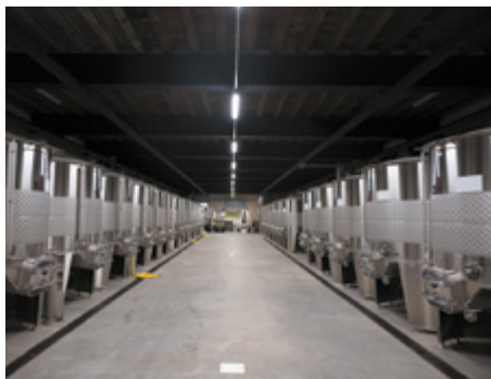
Système de climatisation des élevages en fût, contrôle de l'hydrométrie... La modernité est venue accentuer la qualité des gammes de la Maison.
