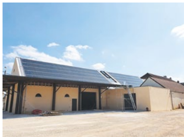
Domaine Clair à Marsannay-la-Côte : intégration au bâti en toiture.
