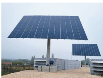
Ferme de minage Mugi à Toucy : tracker solaire.
